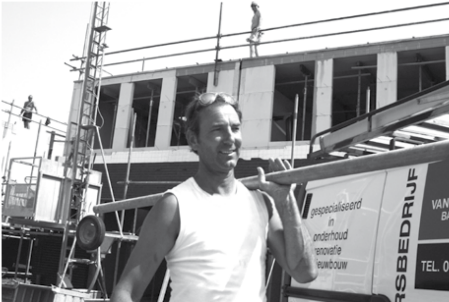
Vrijdag 3 juli: er wordt hard gewerkt aan de tweekappers op Hoebenakker. Petje af voor de bouwvakkers met deze zomerse temperaturen!
